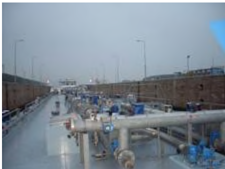
Figuur 4: Aan/afvoer leiding
